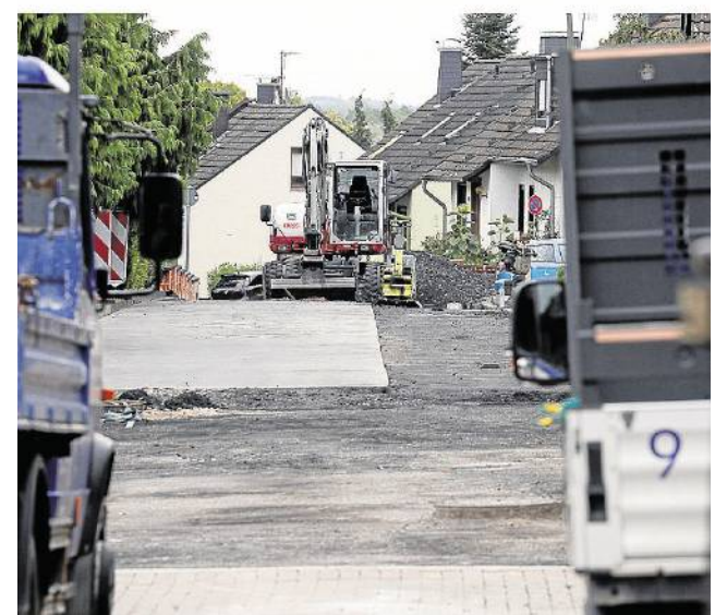
In der Gartensiedlung mussten nach Leitungsschäden die Fahrbahndecken erneuert werden und die Anwohner eine Umleitung in Kauf nehmen.
